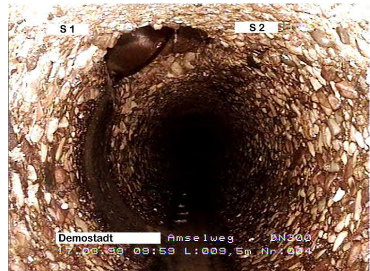
Mechanischer Verschleiß, Korrosion
