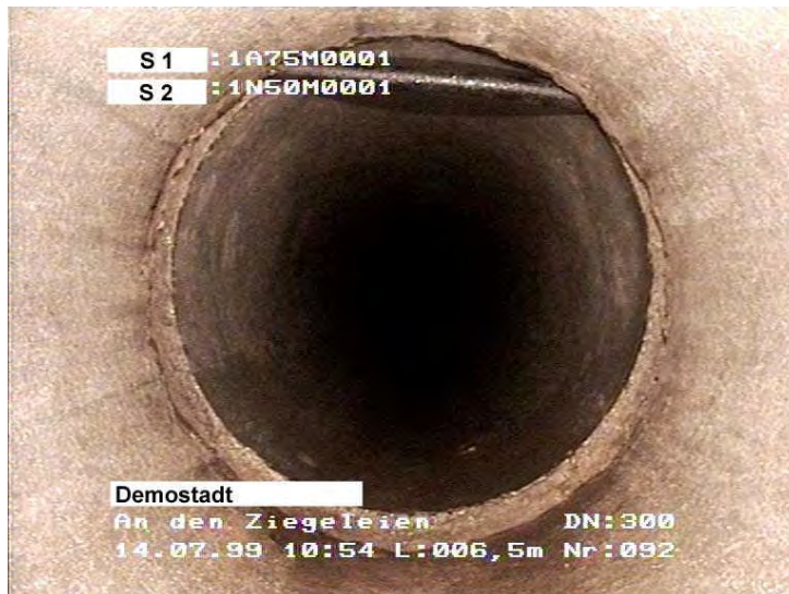
Lageabweichungen, undichte Rohrleitung
