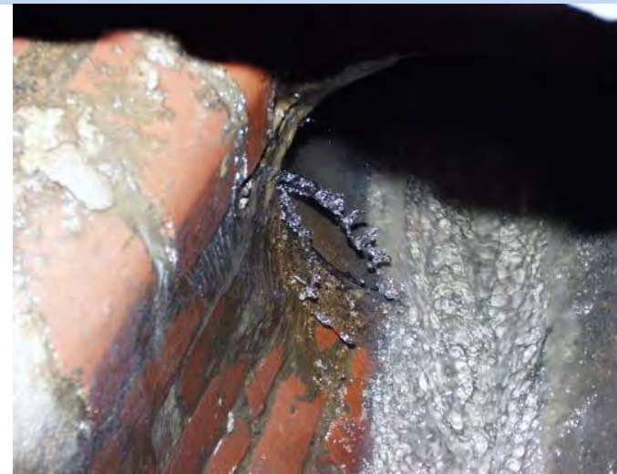
Schachtsohle / Rohrverbindung, Undichtheiten
