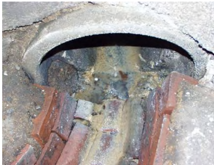
Schacht auf Rohrleitung abgesetzt, Sohle lose Ausmauerung undicht
