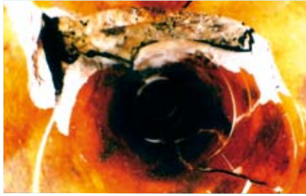
Die Abbildung zeigt ein schadhaftes Abwasserrohr
