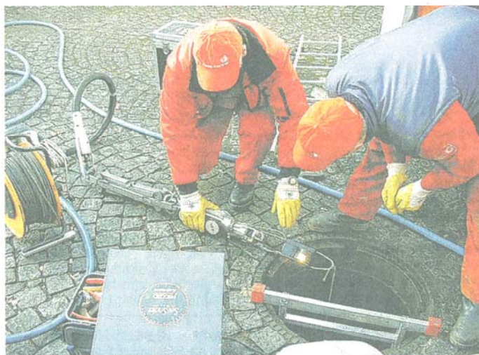
Hausbesitzer müssen in den kommenden Jahren nachweisen, dass ihre Abwasserleitungen dicht sind.
